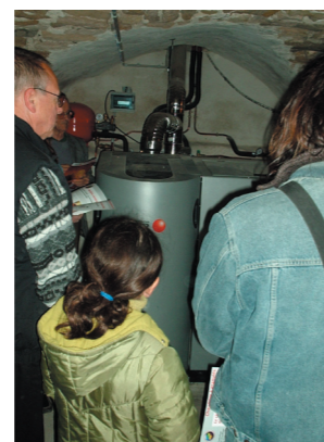
Saint-Etienne de l'Olm, Chaudière à granulés.
