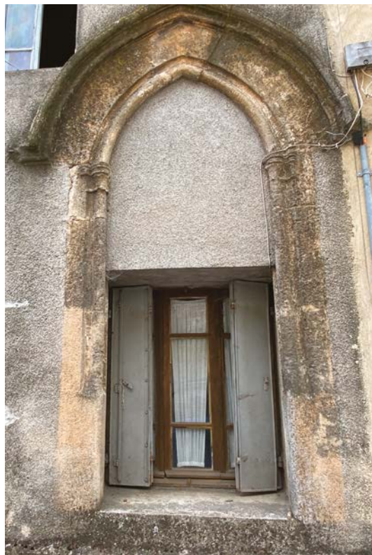
▲ Façades anciennes refaites au ciment artificiel : ces façades historiques, l'une en centre-bourg, comportant une baie gothique, et l'autre, dans un hameau d'altitude, avec une porte de grange au linteau daté, ont été dénaturées par cette réfection. La rigidité du ciment a en outre entraîné l'apparition de fissures.
