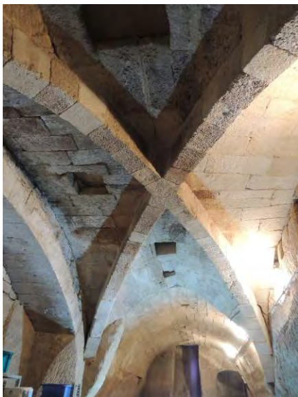
9, rue Pélissier. Cave 1. Croisée d'ogives primitives de section rectangulaire et clef cruciforme.
