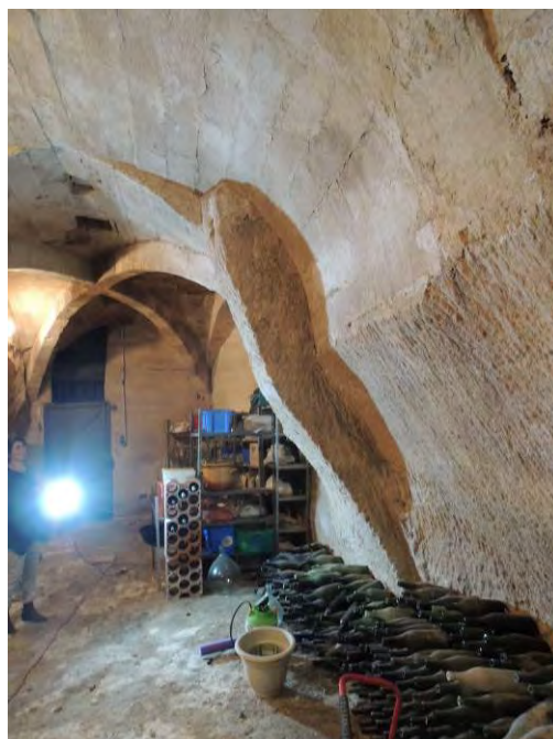
Cave 1. Le rocher, taillé en fort surplomb, sur lequel s'appuient les voûtes.
