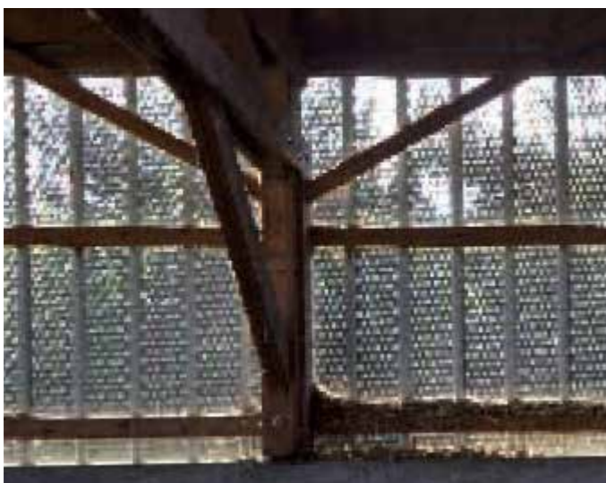
Façade en bac acier perforé:
