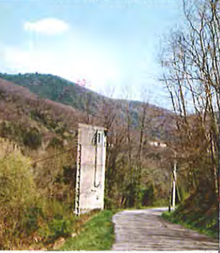
Transformateur sur la D.153
