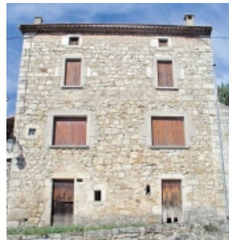
Création de trop grandes ouvertures au premier étage. L'obligation d'un linteau béton, laissé apparent ne contribue pas à l'homogénéité de la façade.
