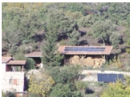
Panneaux solaires sur un bâtiment agricole, Rocles.
