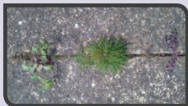
► Végétation entre les joints
