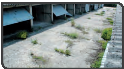
Les surfaces de stationnement en matériaux coulés souffrent dès qu'elles commencent à s'user et se fissurer.
