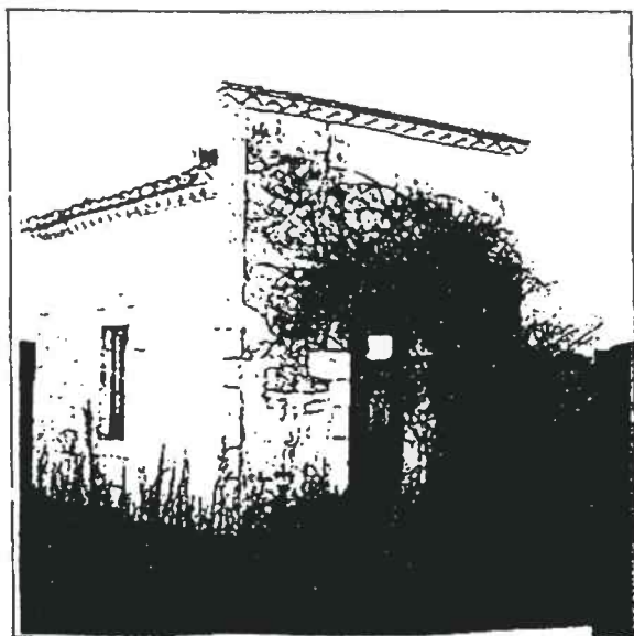
Mazet dégradé sur une terre en friche
