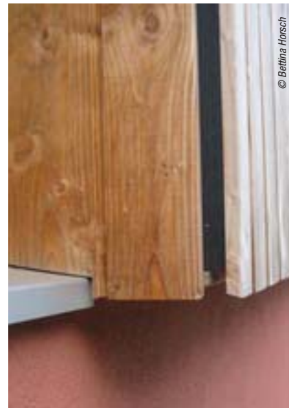
Ici, le joint vertical entre les lames de la façade et celles de l'encadrement de la fenêtre est ouvert, avec une grille anti-rongeur située derrière.
