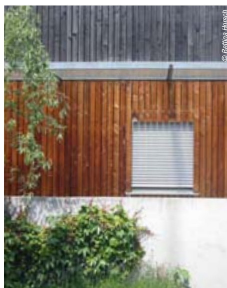
La partie inférieure, entièrement protégée de la pluie mais exposée au soleil, a pris une couleur brune après neuf ans de service.
