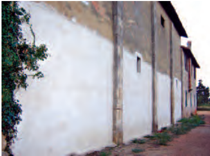
Anciens logements ouvriers en attente de réhabilitation.
