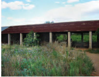
Anciens logements ouvriers en attente de réhabilitation.
