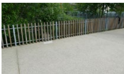
Sol en granulats liés à la résine, école primaire Stéphane Hessel, Montreuil © CAUE de Paris
