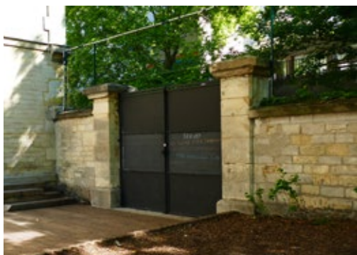
Portail repeint et transformé en tableau d'expression, école 16 rue Riblette, Paris © CAUE de Paris
