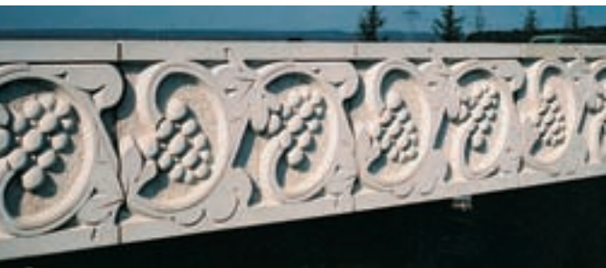
Barbier, Dolveck, Mestoudjian, ponts, La Charité-sur-Loire. Garde-corps réalisés en moules élastomère.
