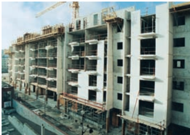
Daniel Kahane, ZAC Didot. Éléments de façade portés mis en œuvre en fin de gros œuvre.
