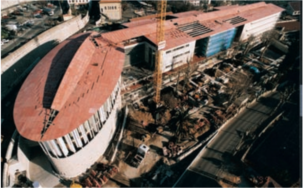
Christian de Portzamparc, Palais de justice, Grasse. Éléments de surtoiture en béton coloré.
