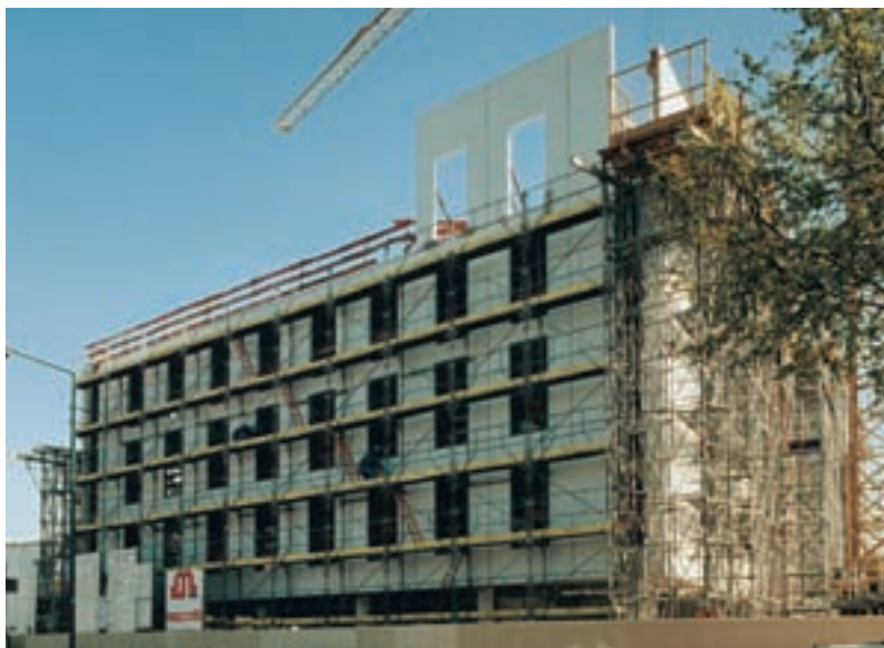
Daniel Kahane, EDF, Rueil. Éléments de façade porteurs mis en œuvre à l'avancement du chantier.
