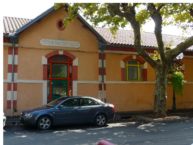
Débord de couverture sur pignon dont les chevrons sont protégés par un lambrequin
