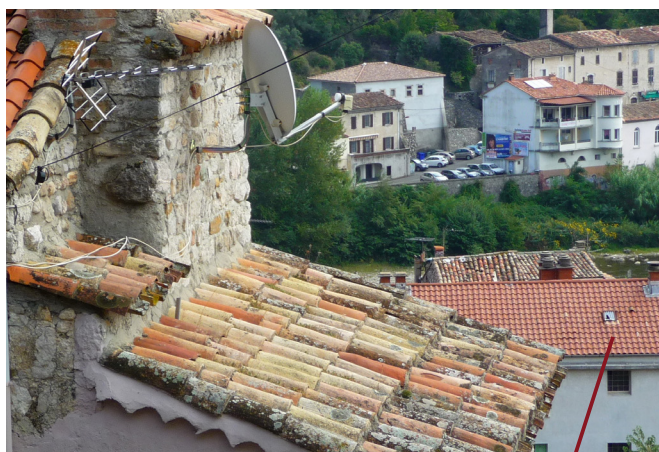
Couverture en tuile romane, fortement déconseillée en centre ancien : sa facture et son aspect industriel sont incompatibles avec les tuiles rondes vieilles au fil des ans
