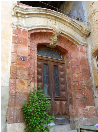
Portail XVIII e : chambranle en granit rouge et entablement en calcaire avec corniche moulurée en «chapeau de gendarme», décor typique du XVIII e
