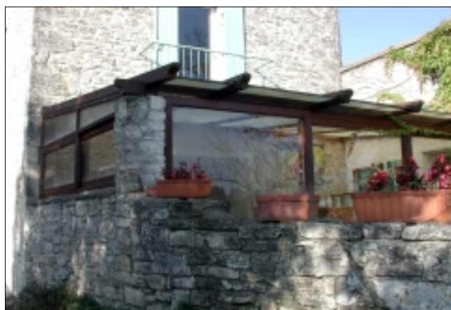
Le choix des matériaux (bois de l'ossature, et polyester de couverture) et de la structure (pente de toit trop faible, dessin des parois créant des vitrages incorrectement proportionnés) créent un élément annexe bien mal adapté au bâti ancien !...
