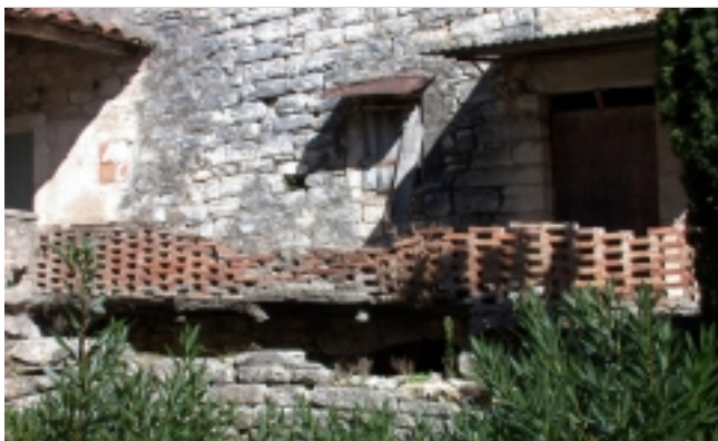
Un exemple de protection à éviter : le «claustra» de terre cuite s'intègre difficilement à l'architecture traditionnelle
