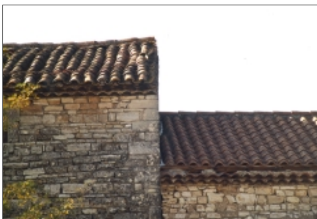
Eviter la cohabitation des tuiles romanes avec les tuiles rondes, de factures trop différentes
