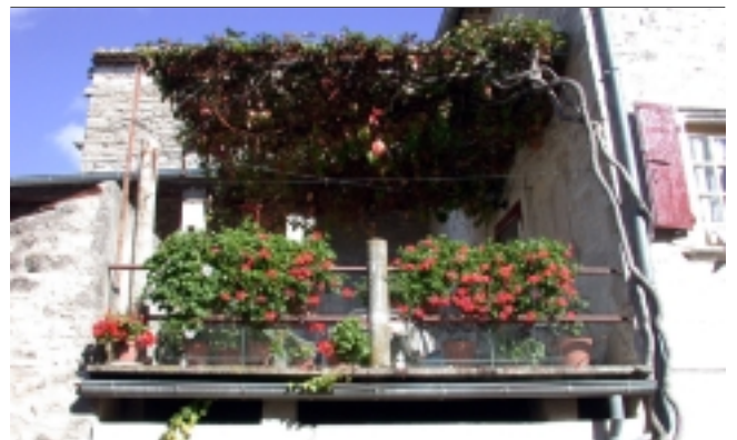
Exemple de garde-corps inspiré des glissières de sécurité routière... qui ne doit pas servir de référence.
