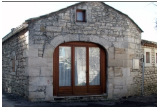
... porte vitrée industrielle inadaptée au tableau. Percement d'origine et menuiserie incompatibles.
