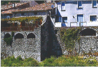
Sumène, façade Est du village : les soubassements des terrasses surplombent le lit de la rivière.
