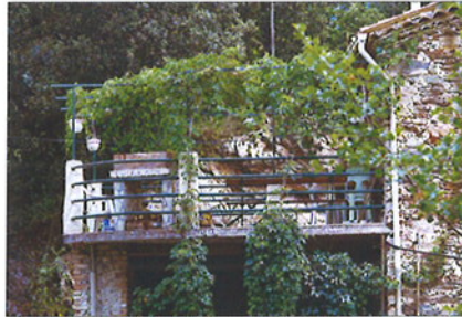
Exemple de garde-corps inspiré des glissières de sécurité routière ... qui ne doit pas servir de référence !
