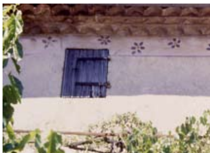
Le débord de toiture protège les façades des intempéries. C'est le rôle que jouent les génoises dans la traditionnelle maison en pierre de la région.
