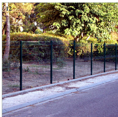
12. Clôture grillagée : des panneaux grillagés soudés, posés à même le sol constituent une clôture de qualité.
