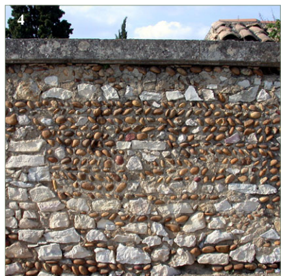
4. Dans les Costières : paroi réalisée avec un parement de galets et pierres hourdés au mortier de terre.
